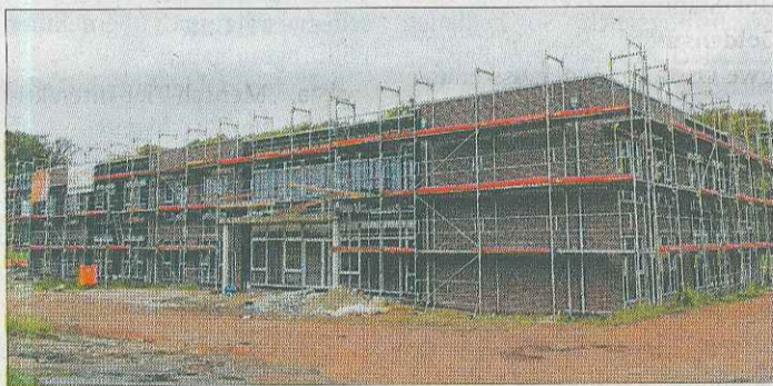
Gut gerüstet: Die Handwerker des Großprojektes an der Franziskusstraße 16 sollen am 31. Oktober fertig sein. Foto: Ferber
